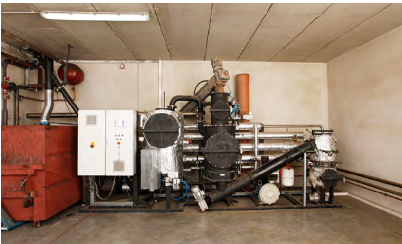
Holzvergasungsanlage zur Energieerzeugung
